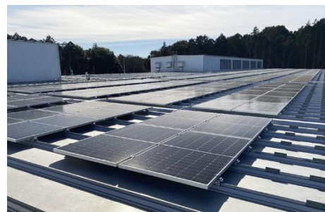
白井データセンターキャンパスに設置した太陽光発電パネル
